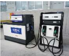
自家用給油設備
